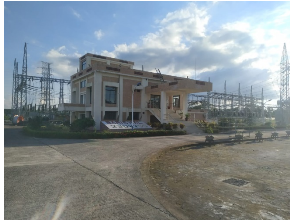
Fig: 4.16. Control room
