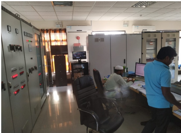
Fig: 4.16. Control room
