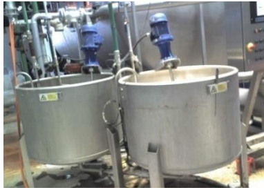
Fig: Dosing Tank
