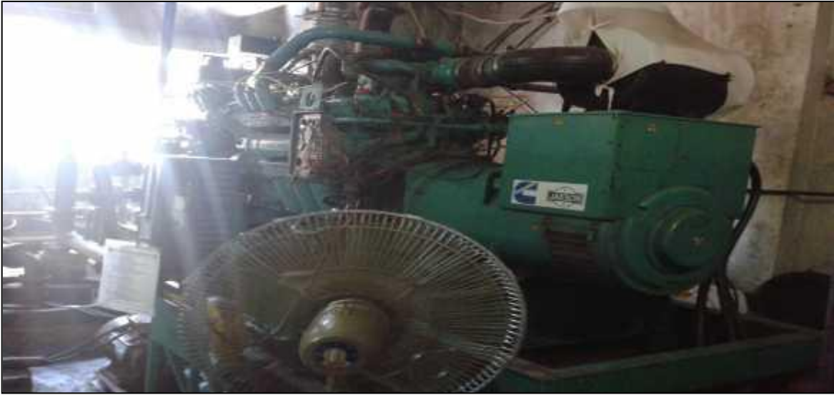
Fig: Gas Generator
